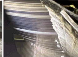
5th 드라이어 실린더 Dryer Cylinder
